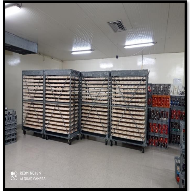
Imagen 3. Cuarto frío de almacenamiento
