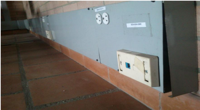
Ilustración 5 Canaleta eléctrica y de red salón 311A
