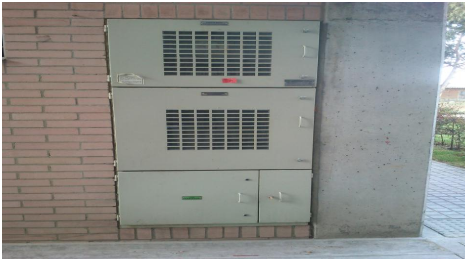
Ilustración 11 Contadores Eléctricos CODENSA
