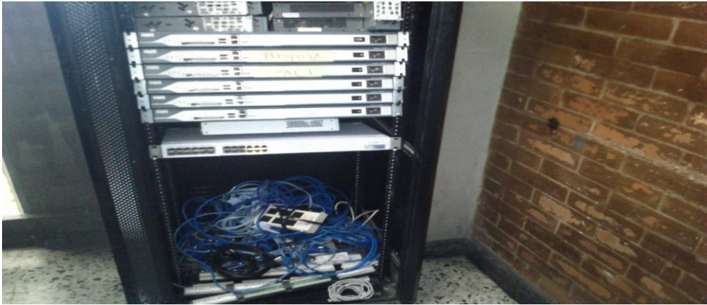
Ilustración 28 Cuarto de Equipos LAB Redes y Seg Inf.
