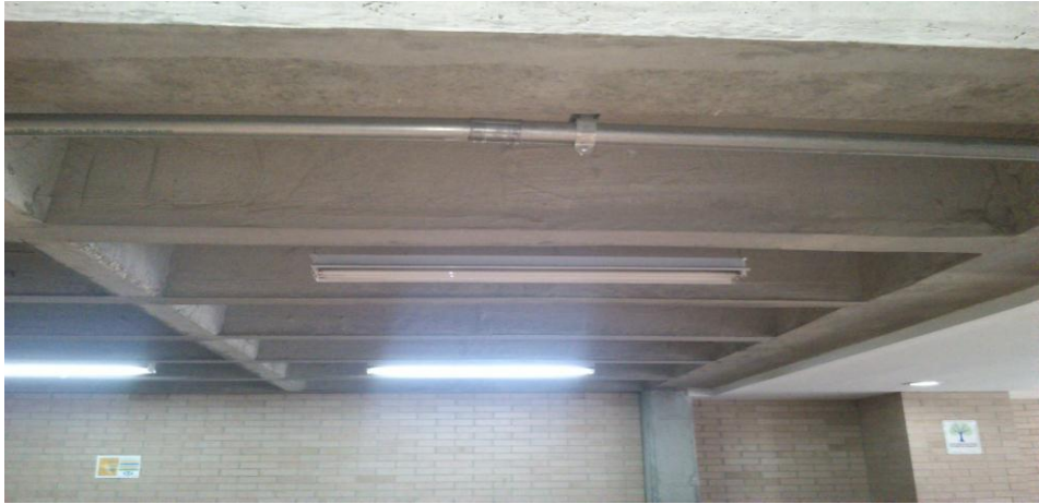
Ilustración 13 Canaleta Eléctrica Edificio
